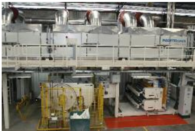
Die Pagendarm Speed Star in der Detailansicht: sie wurde erst im Dezember 2008 in Betrieb genommen
